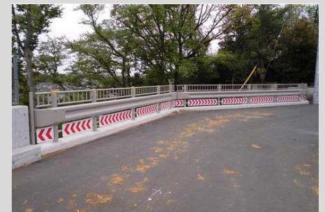
フェンス付きガードレール(反射矢印板付き)
